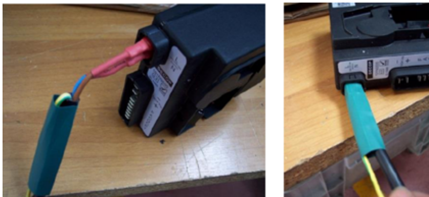
Figura 11: Particolare connessione doppio isolamento
